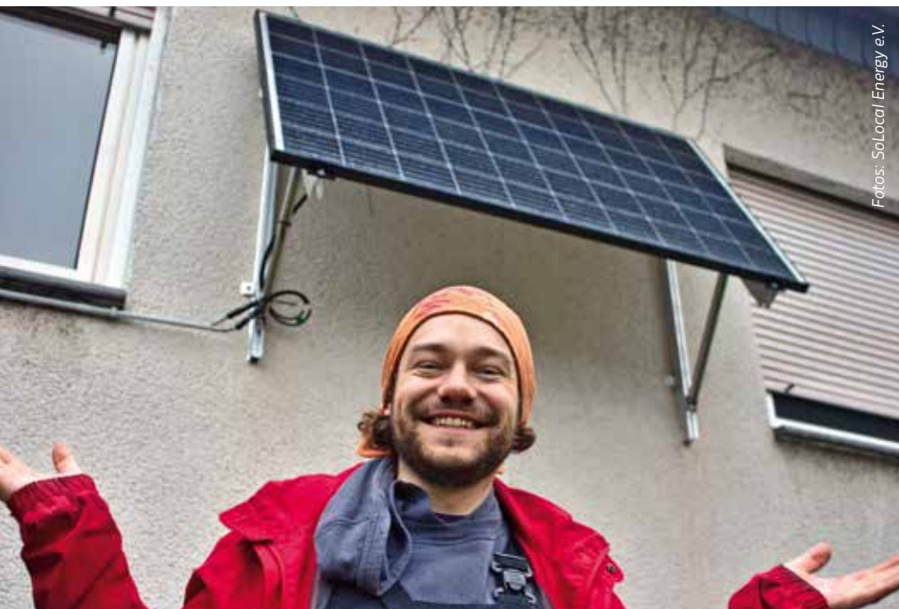
Auch an der Hauswand einfach anzubringen: Solarpaneele eines Balkonkraftwerks.
