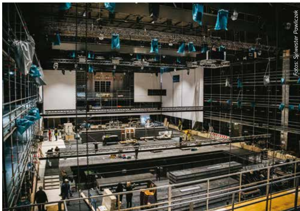
Die hochmoderne Obermaschinerie mit 28 Zügen und ein Steg ermöglichen Verwandlungen über der gesamten Fläche.
